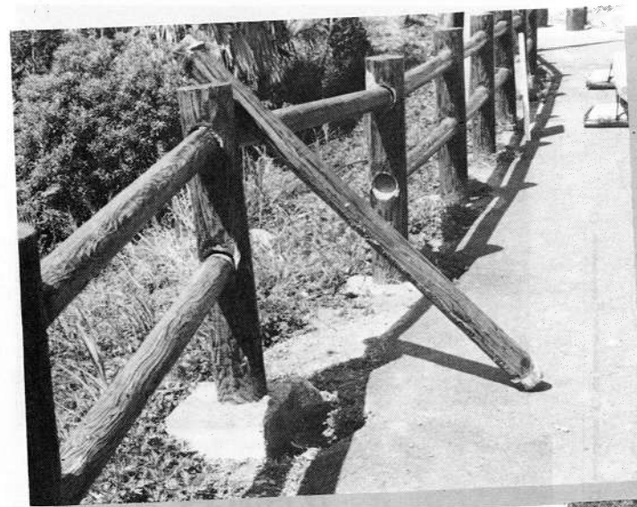
③壊された危険防止の柵（馬ヶ背入り口の駐車場）
