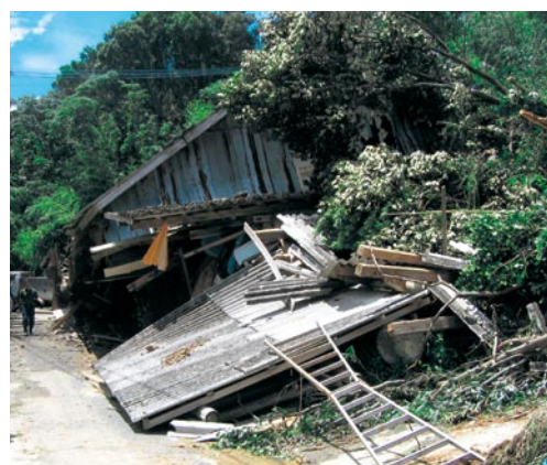
13日 平岩地区金ヶ浜 裏山が崩れ、牛舎が倒壊。親牛 3 頭、子牛 1 頭が土砂に埋まり死ぬ被害があった。
