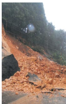
13日 15:25 市道塩見美々津線（旧広域農道）楠群付近のり面崩落現場。市内の各所で道路は寸断された。
