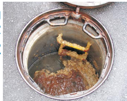
油が主な原因で下水道の本管が詰まりマンホール蓋付近まで汚水が溢れたもの
