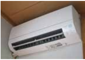
新財市区が購入した空調設備
