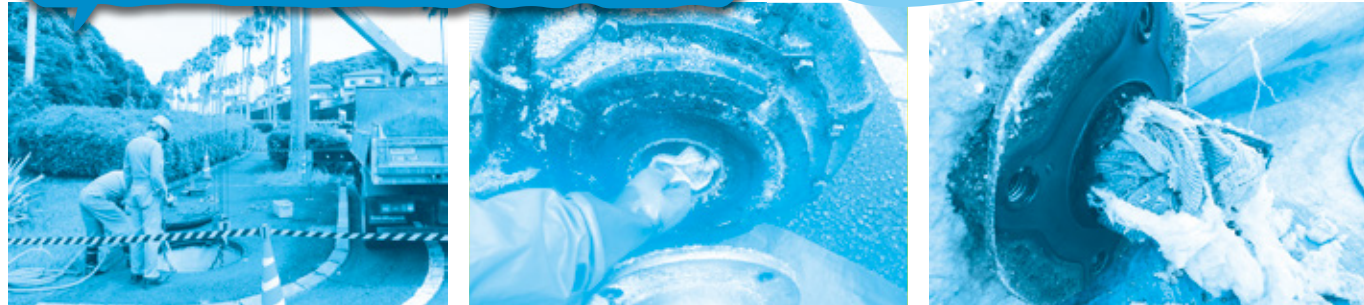
タオルなどの布類の詰まり
