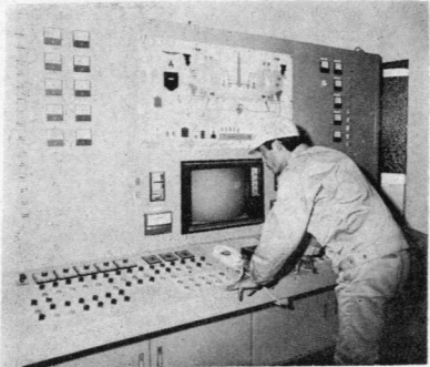
中央制御室で集中管理
