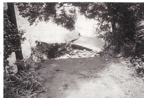
▲河川の増水で決壊した接岸道路
