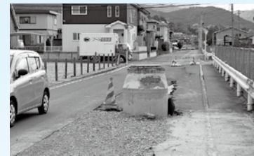
地震により隆起したマンホール
